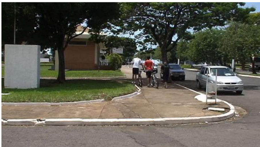
Figura 22: Foto da Praça do Burguês, com a foto podemos notar a falta de rampas de acesso, além do piso irregular o que dificulta o acesso das pessoas com necessidades especiais.
