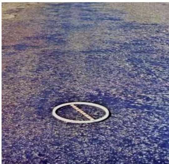
Figura 2: Exsudação de pavimento.
