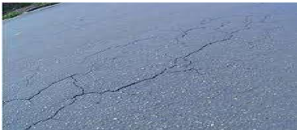
Figura 13: Trinca de retração.
