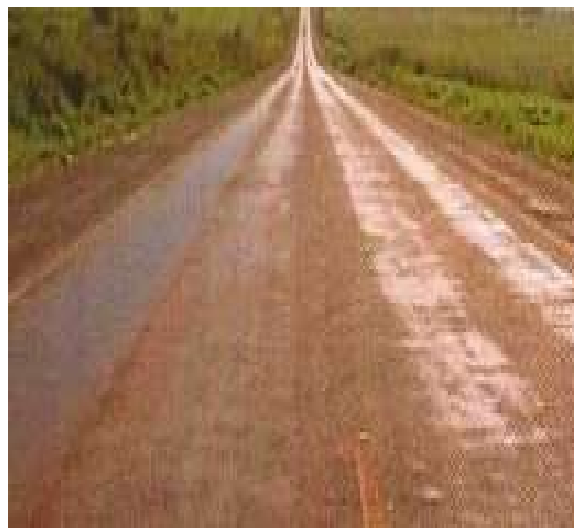
Figura 3: Exsudação de pavimento.
