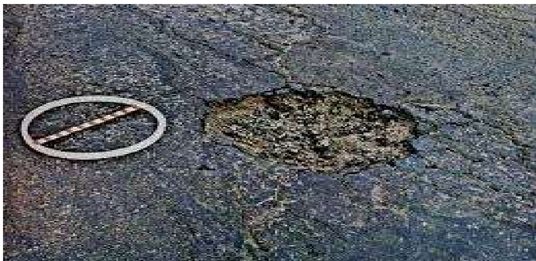
Figura 11: Panelas ou buracos.
