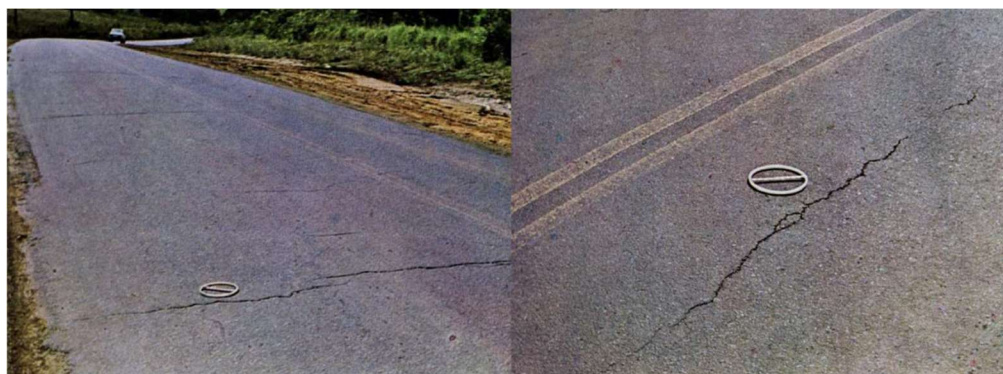
Figura 8: Trinca transversal e trinca longitudinal
