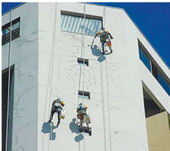
Figura 6: Fissura por retração.
