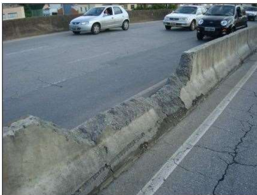
Figura 9: Deterioração do concreto por ações mecânicas.
