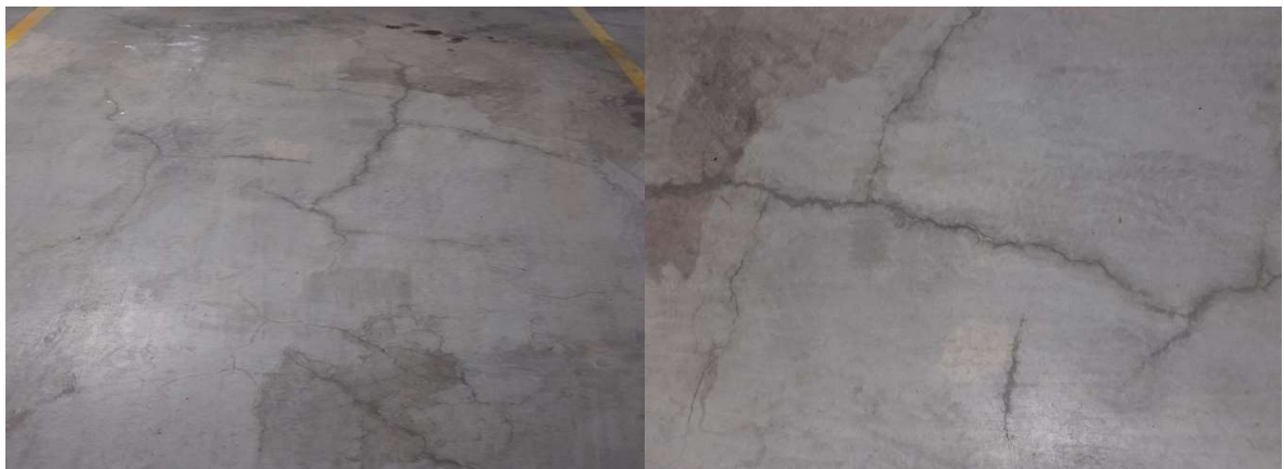
Figura 6: Lixiviação e fissuras no piso do estacionamento.
