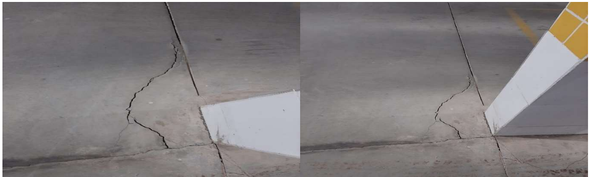
Figura 7: trincas entre as juntas de dilatação do piso.
