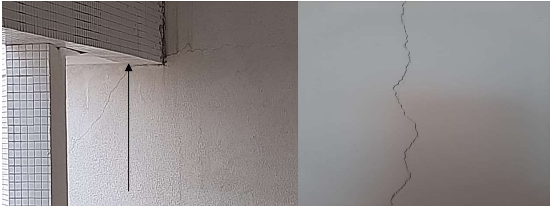
Figura 3: Trincas na parede da academia.
