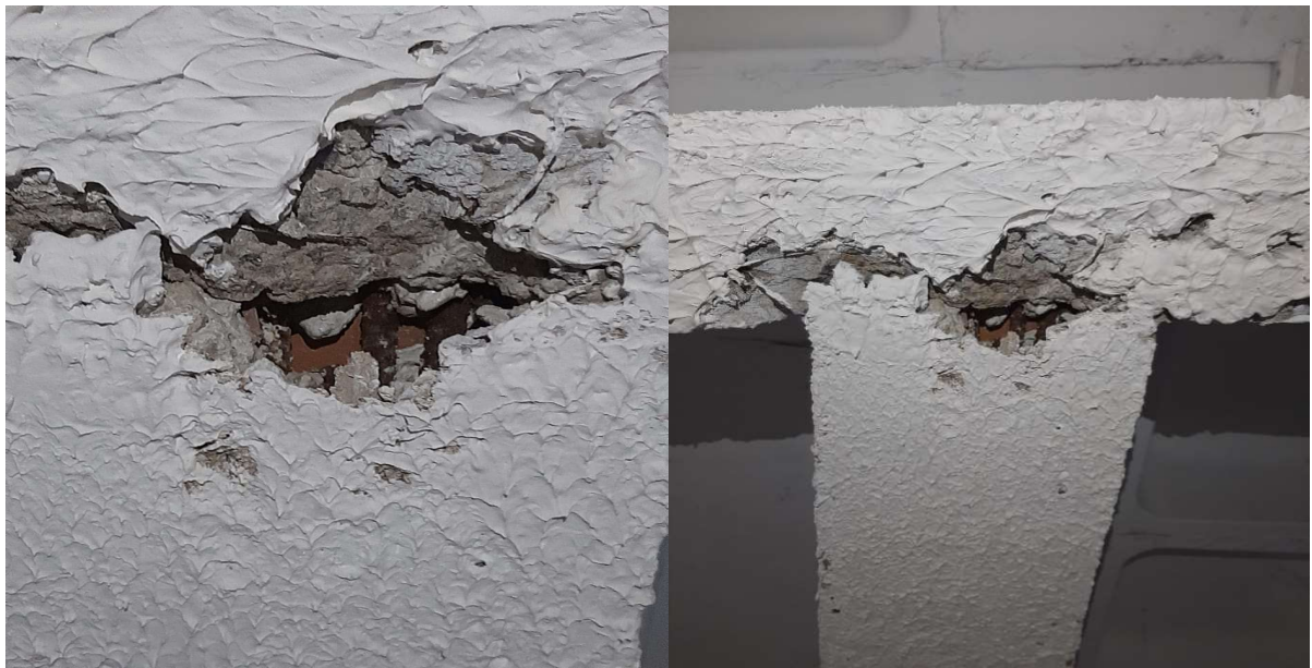
Figura 8: Falha no cobrimento da armadura.
