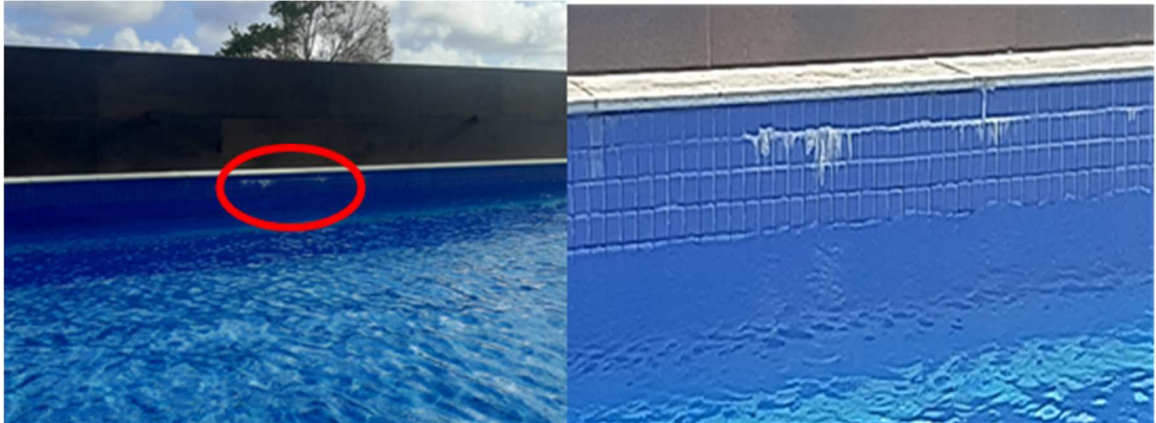
Figura 5: Eflorescência na raia semi-olímpica.
