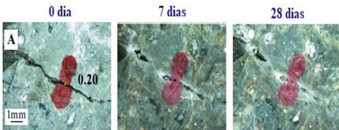
Figura 3: Autocicatrização natural do concreto
