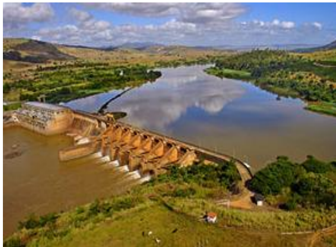
Figura 1: Vista da crista da barragem e vertedouro, margem esquerda da UHE Mascarenhas
