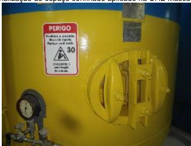
Figura 4: Sinalização de espaço confinado aplicado na UHE Mascarenhas.
