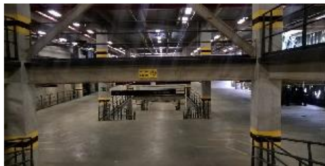
Figura 4 - Pilares em concreto e vigas de aço da estrutura do edifício-garagem da CA. Fonte: os autores
