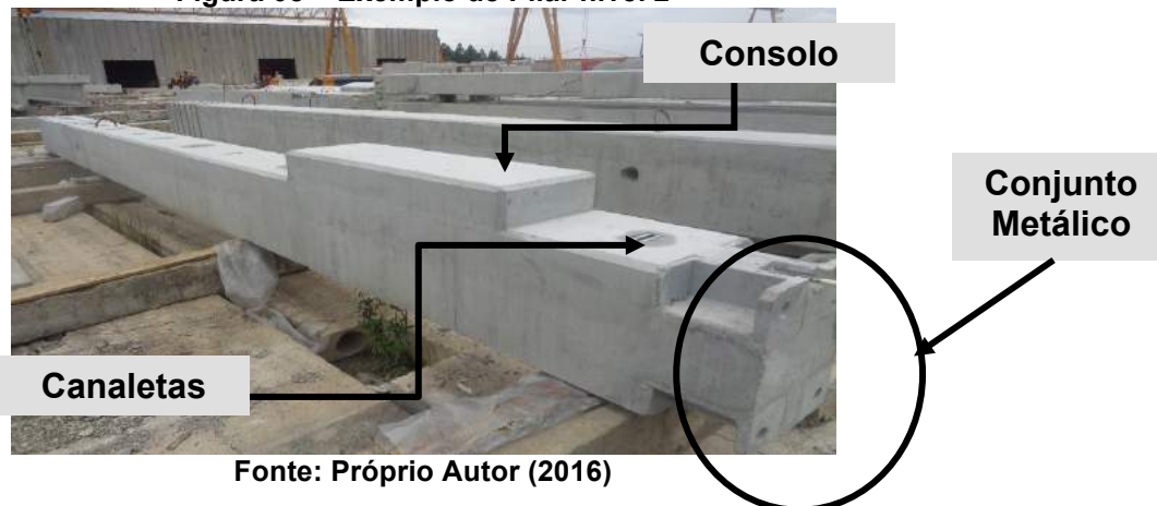
Figura 08 – Exemplo de Pilar nível 2
