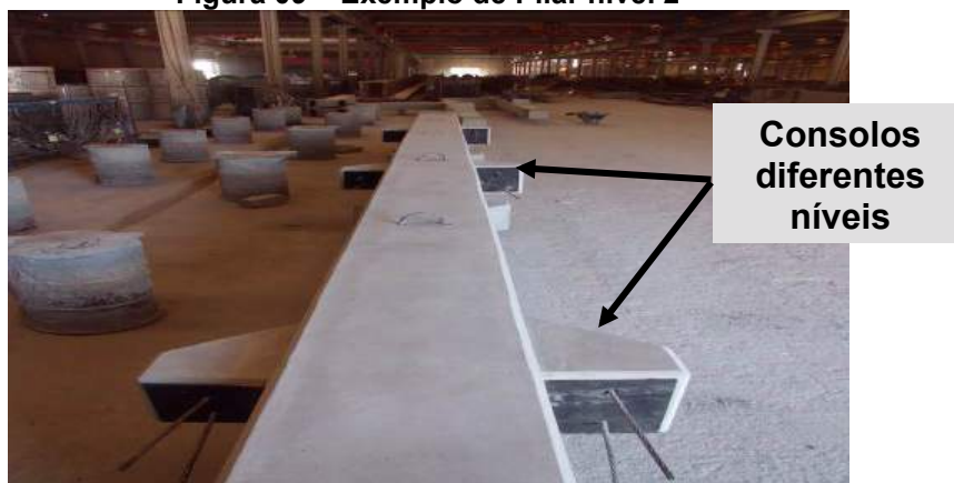
Figura 09 – Exemplo de Pilar nível 2
