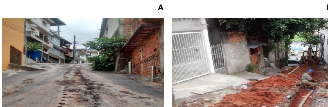
Figura 3 – A - Rua Alberto Soares da Silva, antes do início das obras; B - Rua Dina, durante execução das obras.
