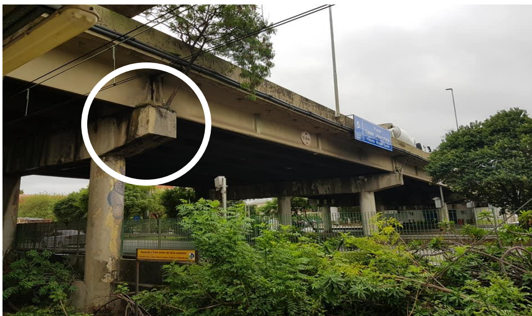
Figura 5. Patologia na lateral da ponte, infiltração e formação de pequenas árvores - Ponte Cidade Universitária (Foto: Yuri Teixeira, 2019).
