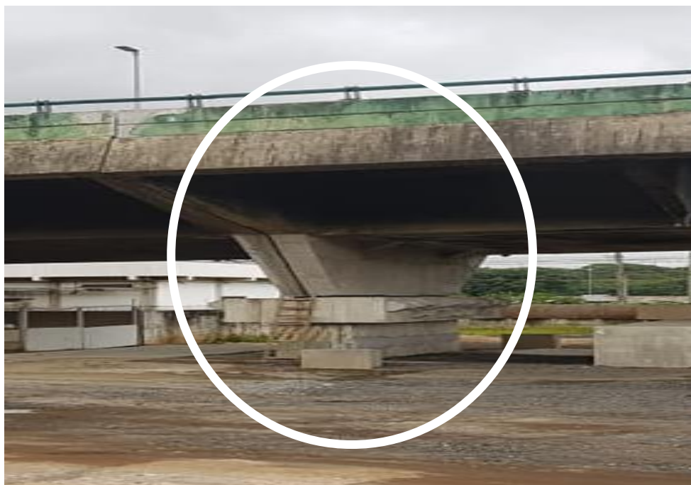
Figura 4. Reparo realizado na mesoestrutura de um Viaduto na Marginal Pinheiros, após este ceder (Foto: Yuri Teixeira, 2019).
